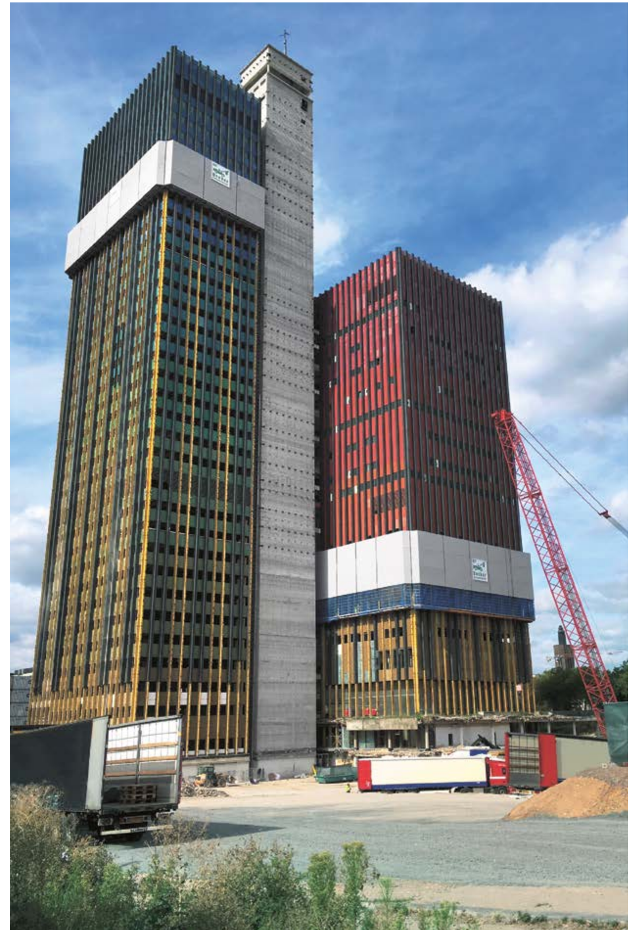
Sowohl der Büroturm (links) als auch der Studioturm wurden für den Rückbau ringsum mit dem Schutzschild Xclimb 60 eingehaust.
