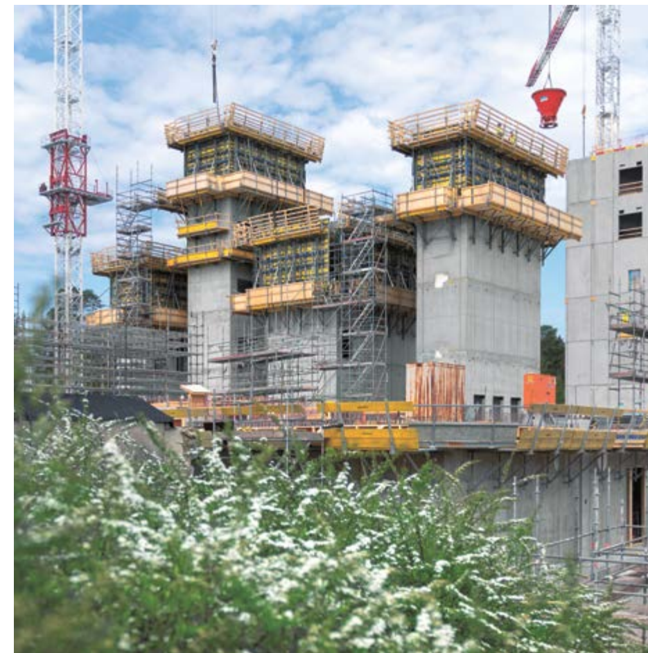
1, 2 Das Gebäude B des Krankenhauses entsteht mit der Kletterschalung MF240 und der Rahmenschalung Framax Xlife plus.
